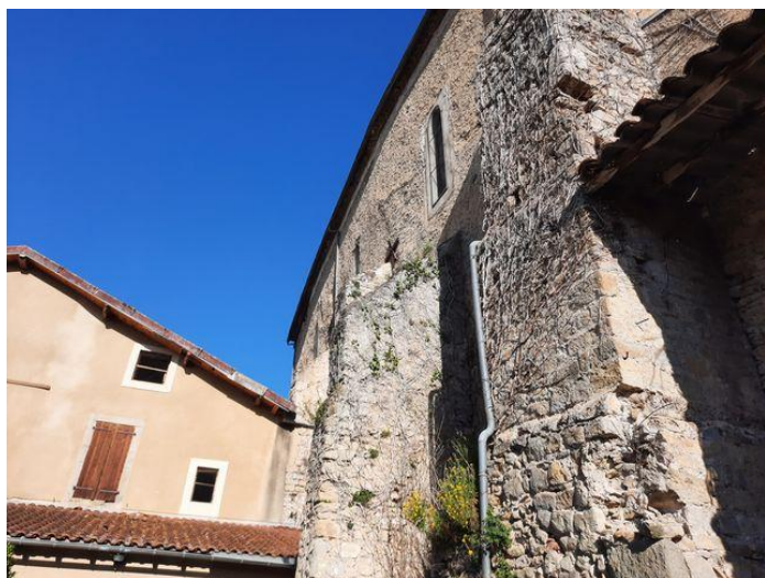
Déformation de maçonnerie
