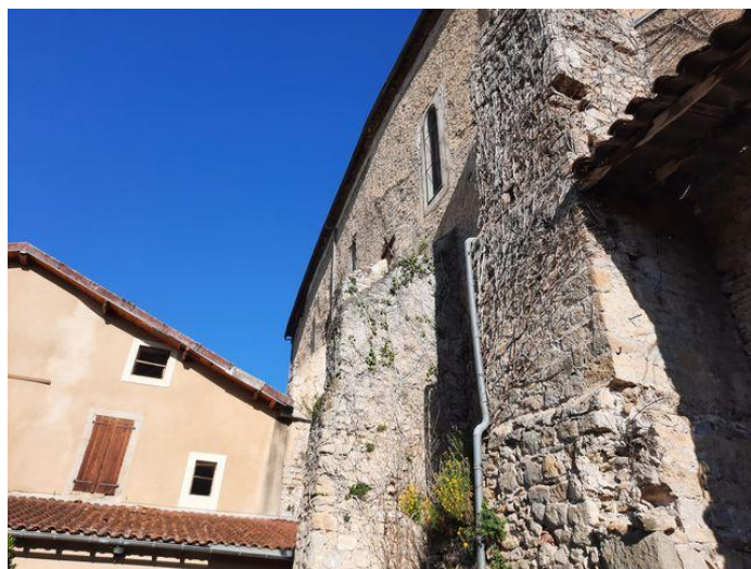
Croissance de végétaux dans un contrefort
