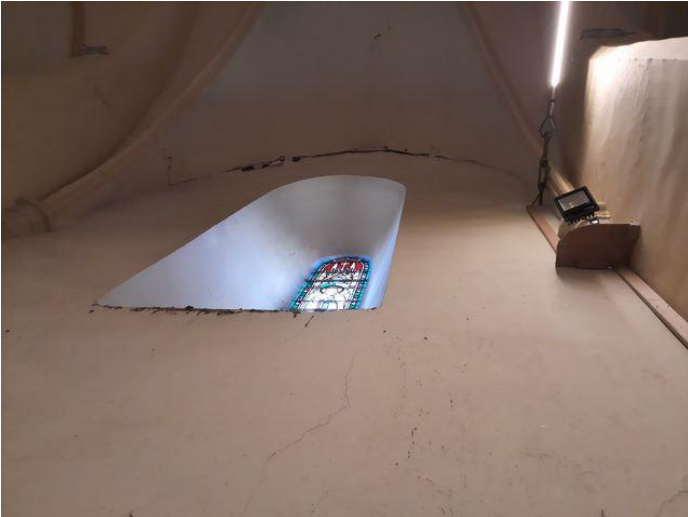
Fissurations verticales sur le mur Sud
