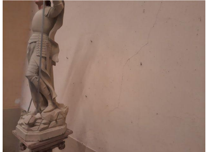
Fissurations verticales sur le mur Sud
