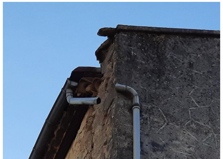
Discontinuité de gestion des eaux pluviales
