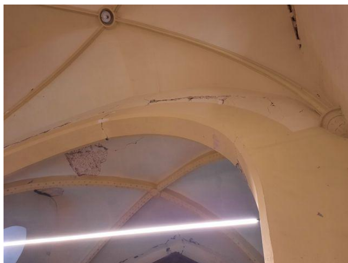
Fissuration de voûte
