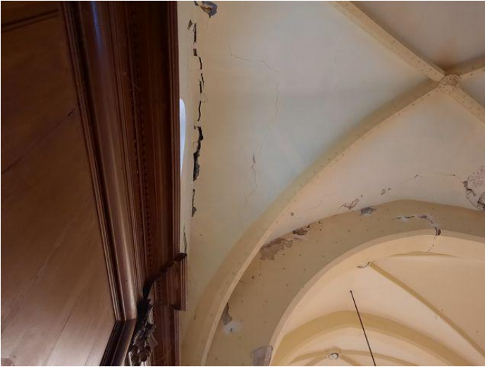
Fissuration mur Nord
