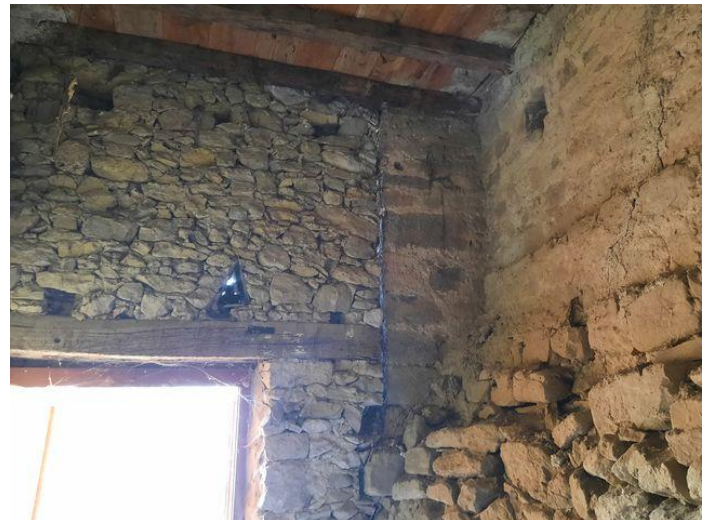
Discontinuité des maçonneries
