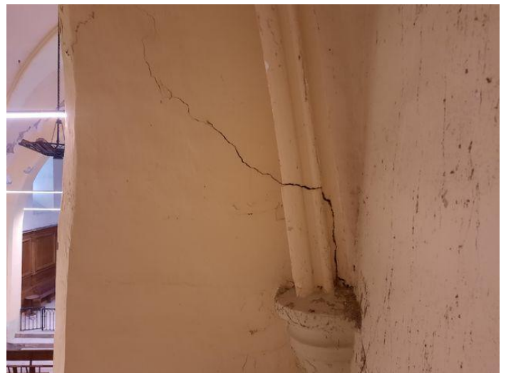
Fissuration du daveau partant du sommier
