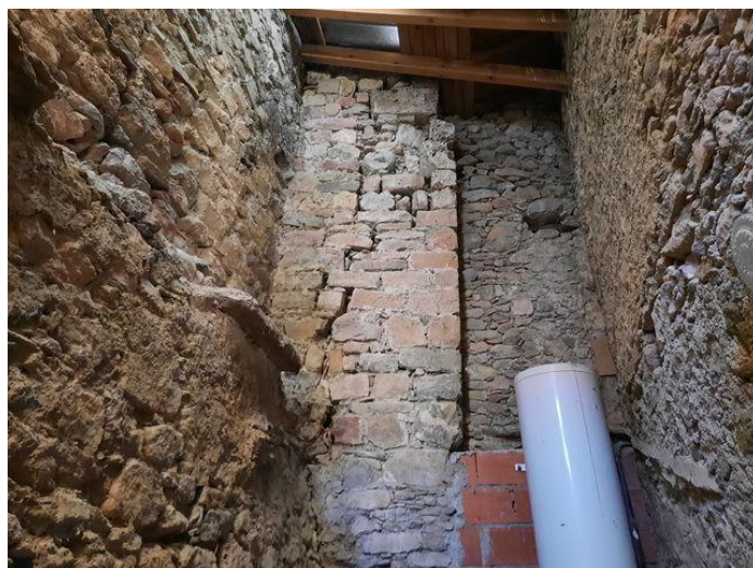
Glissement de pierres sur contrefort Sud
