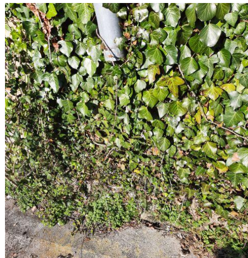
Evacuation en pied d'ouvrage
