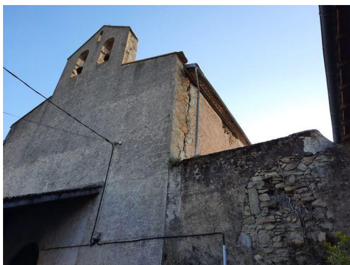
Basculement mur Sud / mur Clocher
