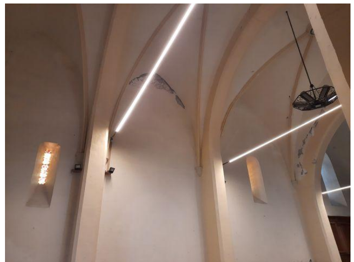
Fissuration mur Sud
