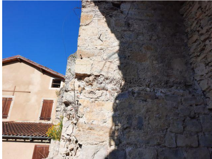
Dégradation de pierres du contrefort
