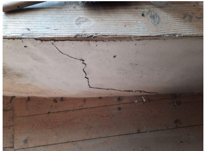
Fissure sous appui de fenêtre
