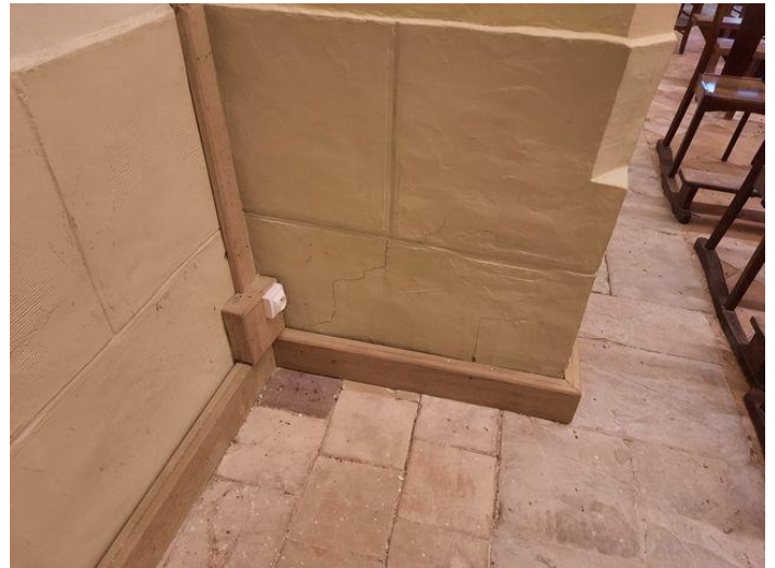
Fissuration du piédroit
