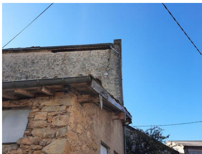
Basculement mur Nord / mur Clocher
