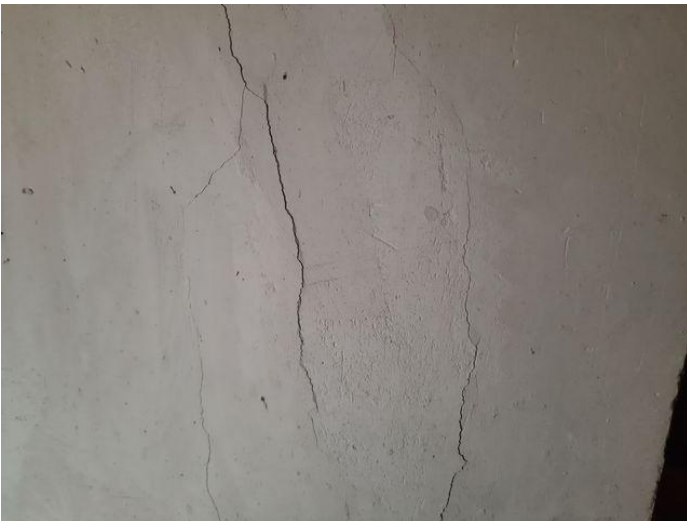
Fissures en hachures
