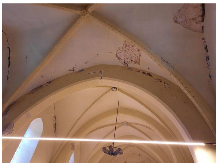
Fissuration de voûte
