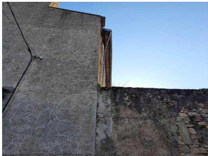
Basculement du mur Sud
