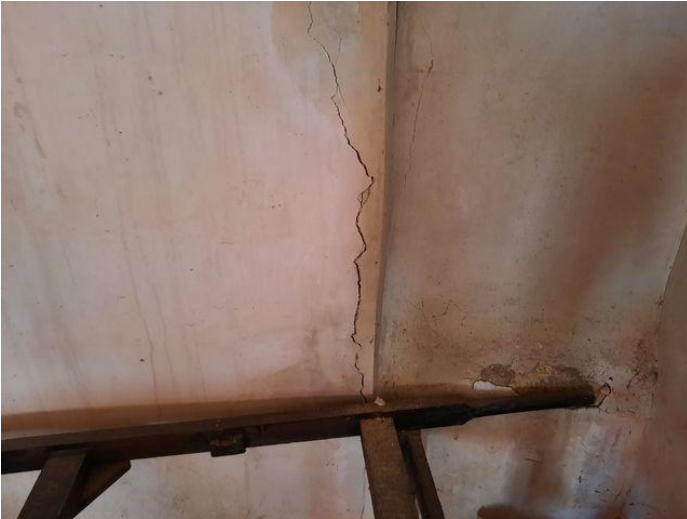
Fissure en jonction de maçonneries
