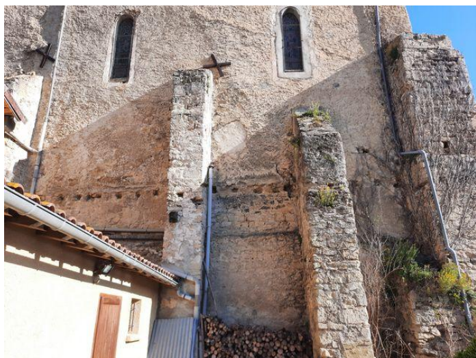
Croissance de végétaux dans un contrefort
