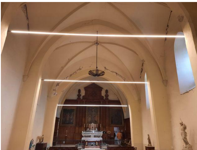
Fissurations des premières travées
