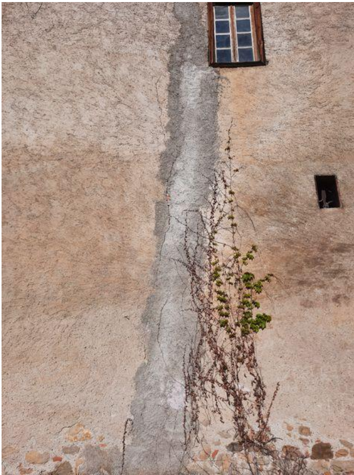
Fissure verticale du mur de la sacristie
