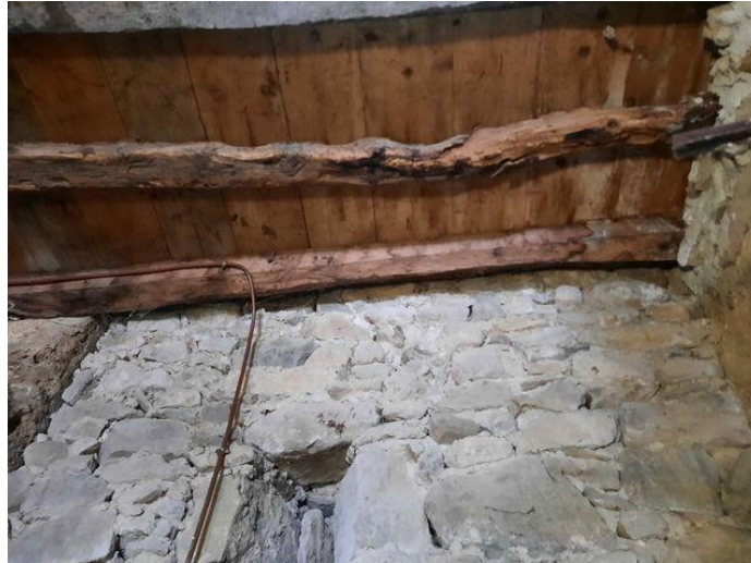
Solivage dégradé, Nord de la sacristie
