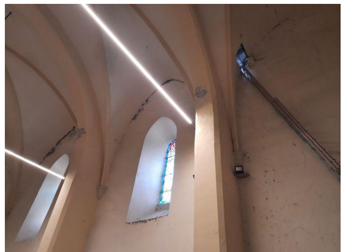
Fissurations mur Sud
