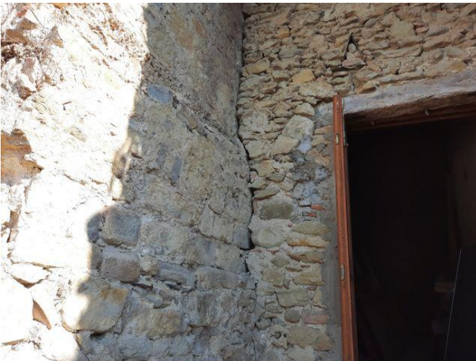
Discontinuité des maçonneries
