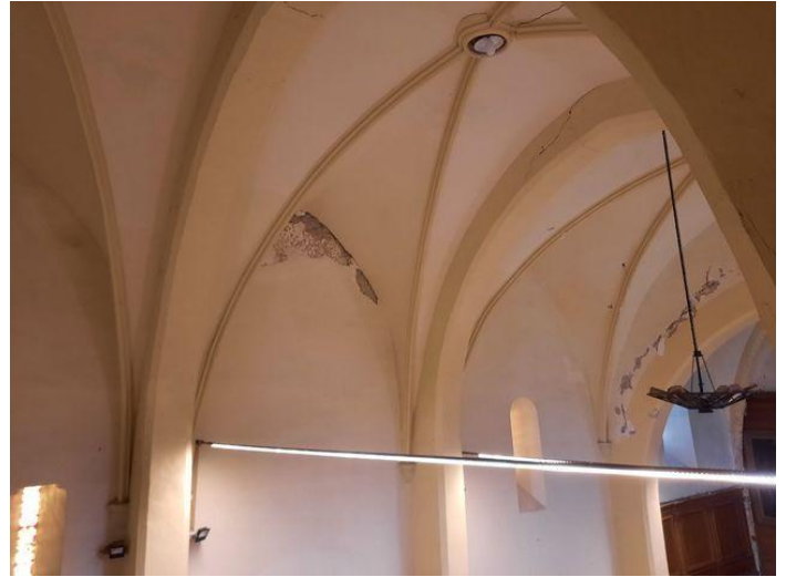
Fissuration mur Nord
