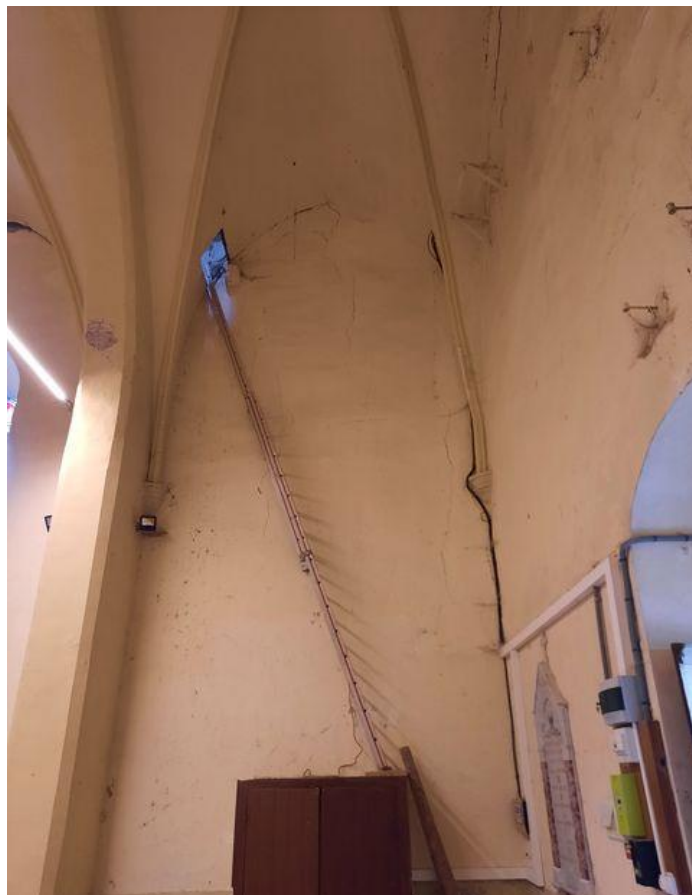
Fissure jonction mur Clocher / mur Sud
