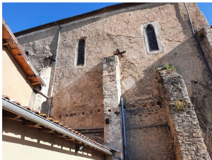
Clé de tirant et déformation de maçonnerie
