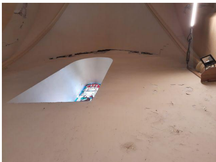
Fissuration mur Sud
