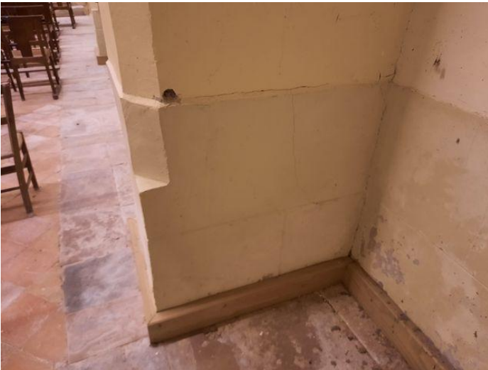
Fissuration du piédroit
