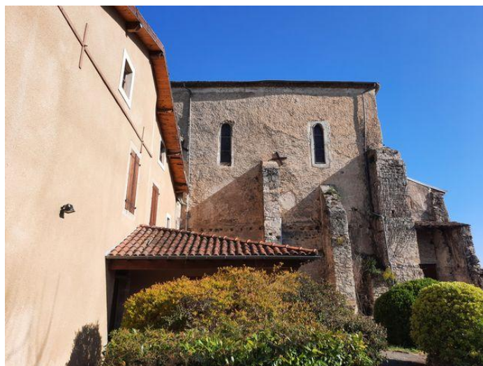
Déformation de maçonnerie
