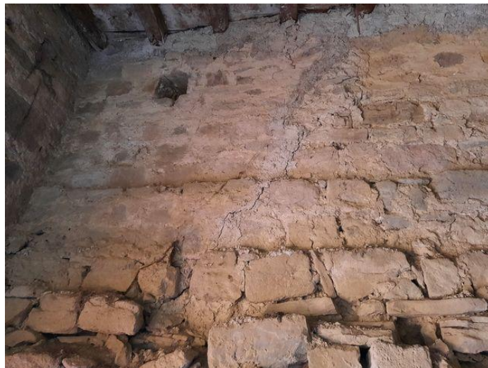
Fissure oblique du mur Est
