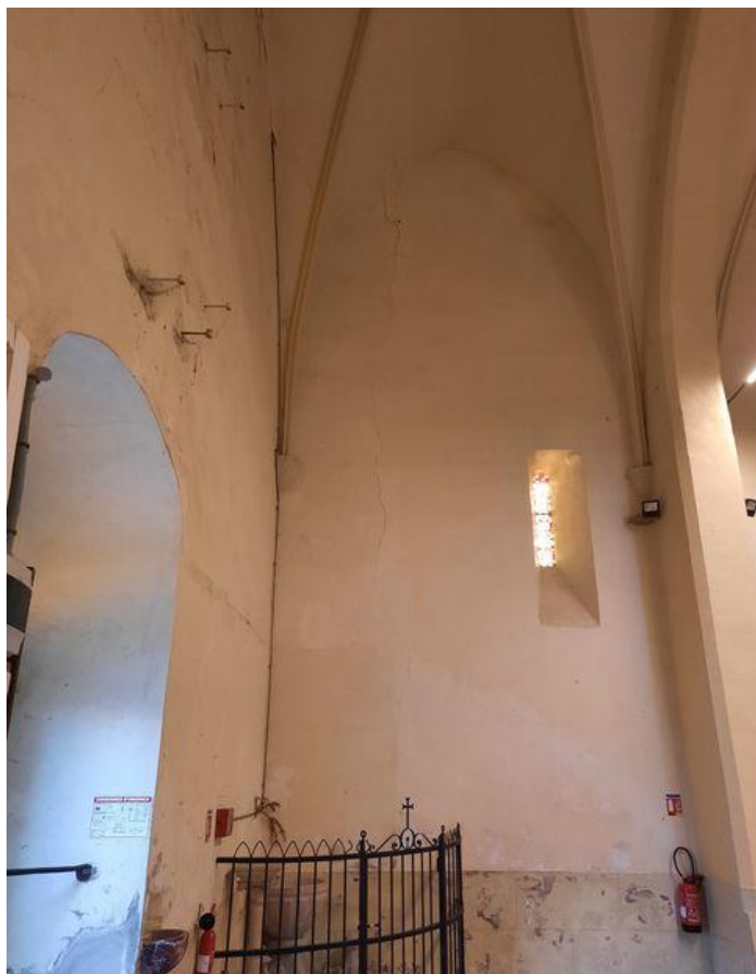
Fissure jonction mur Clocher / mur Nord
