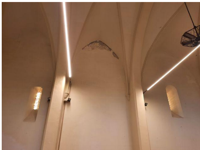
Fissurations mur Sud
