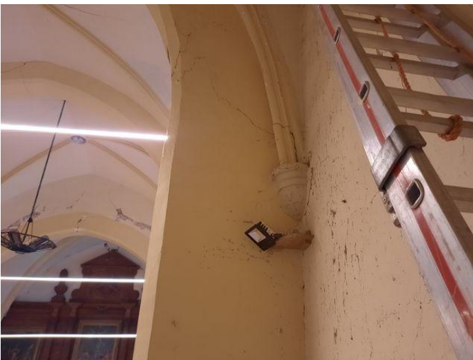
Fissuration du daveau partant du sommier
