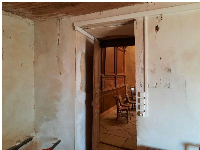
Fissuration de part et d'autre de la porte d'accès
