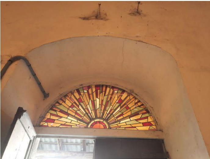
Fissuration de la voûte de la porte d'entrée
