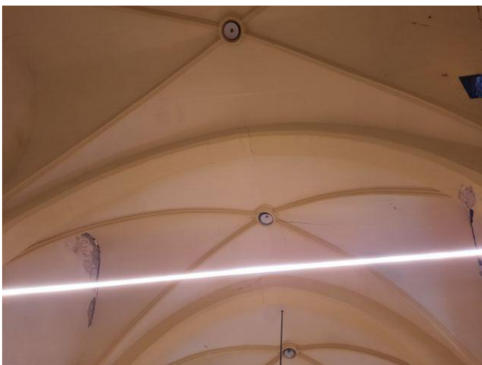
Fissurations de voûtes
